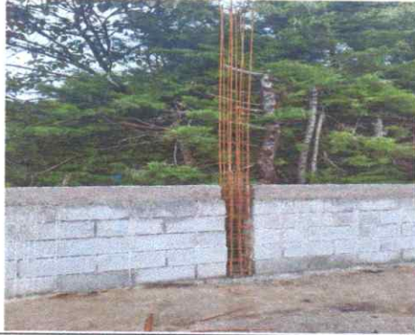
Foto 1: Estado actual de las paredes a mejorar.
